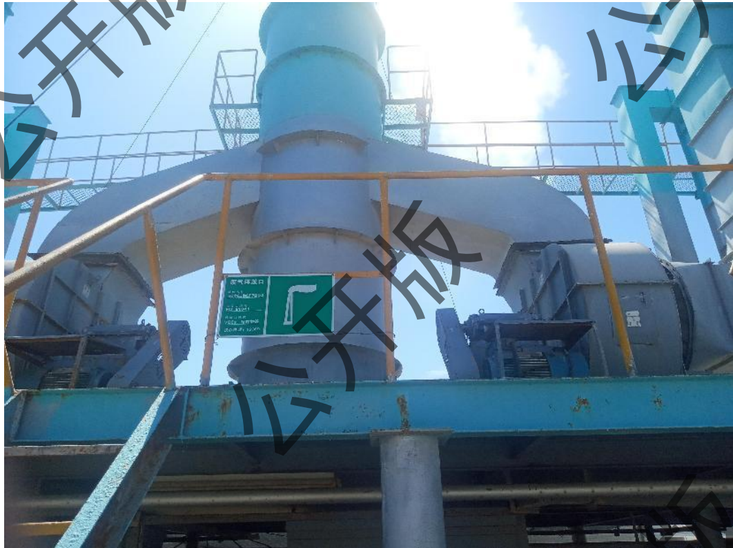
图 4-1 本项目依托排气筒现场照片
